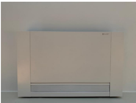
Viftekonvektor v/ himling i stue/kjøkken.
