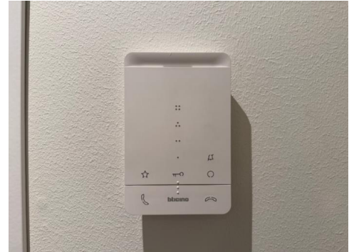
Dørtelefon i entre/gang.
