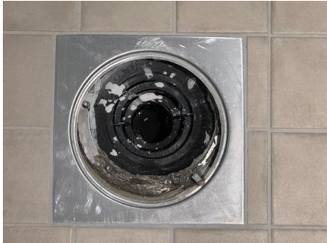
Plastsluk i dusjsone.
