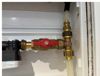
Stoppekran i rør i rør skap.
