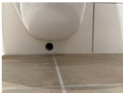
Drenshull under vegghegt toalett. Dersom det oppstår en lekkasje i kasse bak vegghegt toalett vil lekkasjevann bli synlig gjennom drenshull.
