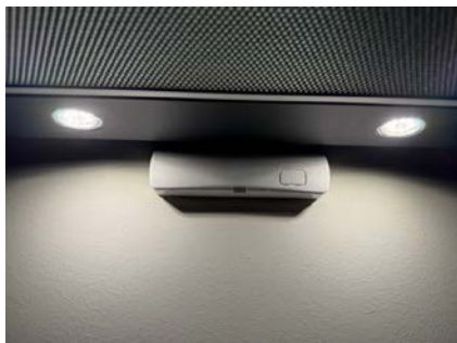
Komfyrvakt v/ kjøkkenventilator.
