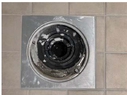
Plastsluk i dusjsone.
