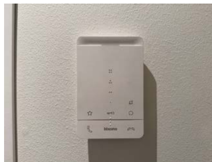
Dørtelefon i entre/gang.
