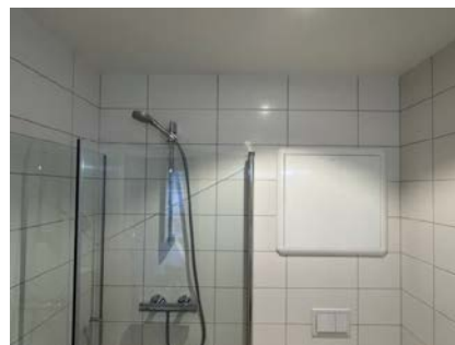
Rør i rør skap i våtsone.
