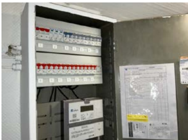
Automatsikringer i sikringskap plassert i gang i kjeller.
