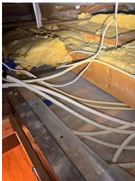
Mangel full isolasjon i bjelkelag.
