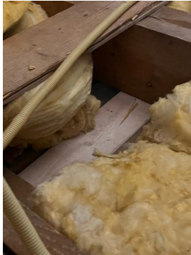
Mangel full isolasjon i bjelkelag.
