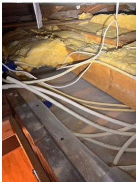
Mangel full isolasjon i bjelkelag.
