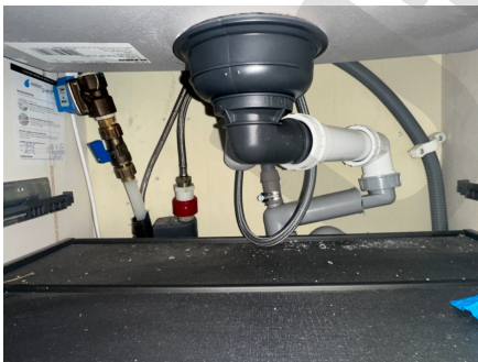
Røropplegg i kjøkkenbenk med Waterguard
