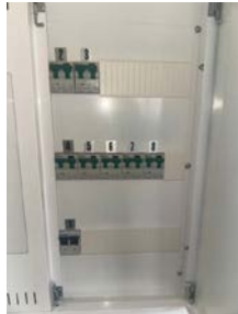
Sikringskap med automatsikringer.
