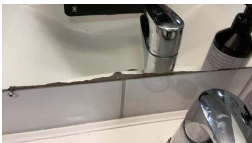
Skade på speil.
