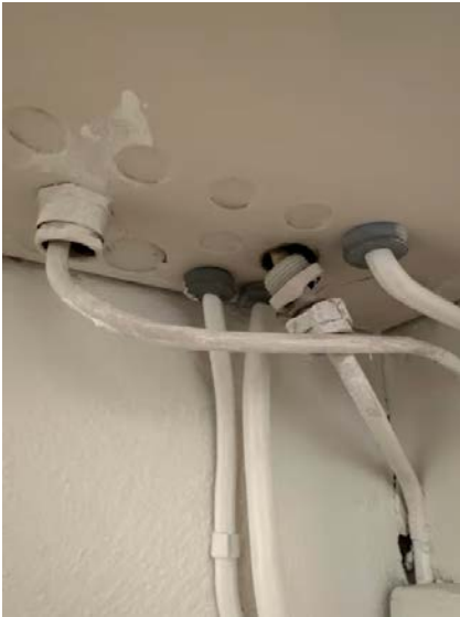
Det registreres utettheter ved gjennomføringer. Nippel for kabelgjennomføring er defekt.
