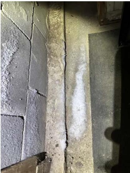
Det er påvist indikasjoner på fuktgjennomtrenging i kjellergulv og grunnmur.
