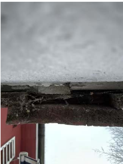
Viser lufting av kledningen. Det anbefales å etablere musetetting bak kledning.
