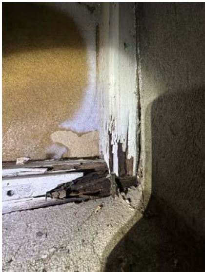
Viser råteskade i karm på vindu i kjeller.
