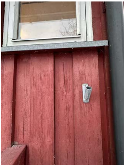
Viser værsliitt/oppstrukket trevirke ved inngangsparti.
