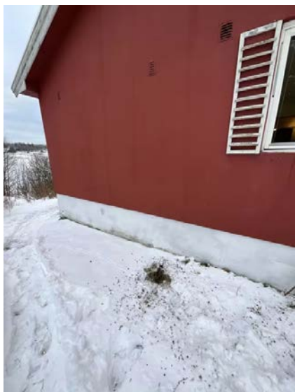
Det er ikke registrert bruk av fuksikring ved grunnmur.
