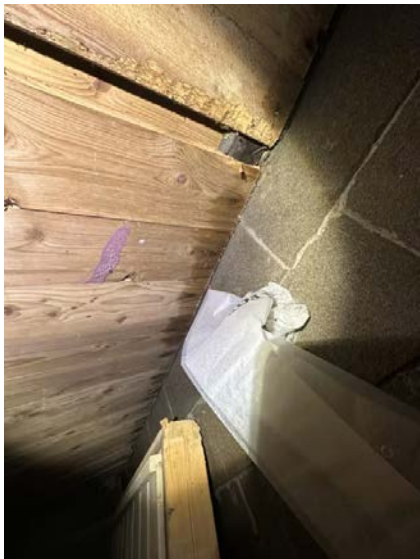
Takpanel ført mot grunnmur trekker fukt.
