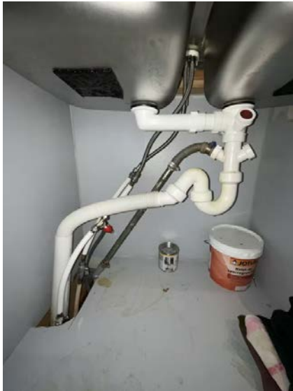
Viser vann- og avløpsinnstallasjoner under kum.
