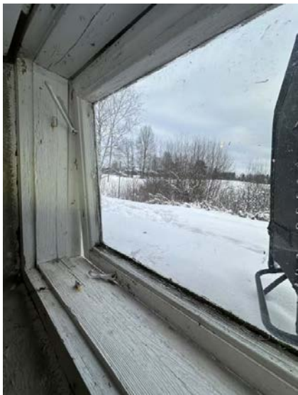
Viser skader i karm og kondensskader. Vindu lot seg ikke stenge.
