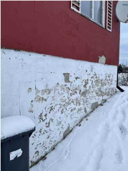
Viser manglende vedlikehold/ skader på fasader.
