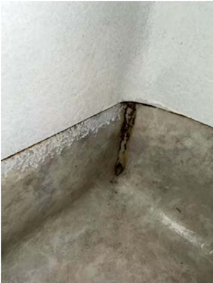
Det registreres misfarging i fugemasse som kan skyldes feil type silikon (uten soppdreper).
