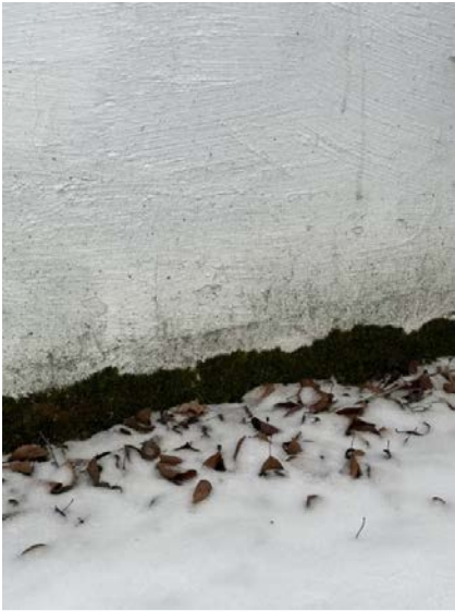
Viser mosegroing mot grunnmur og indikasjon på høy fuktighet i fasadematerialene.
