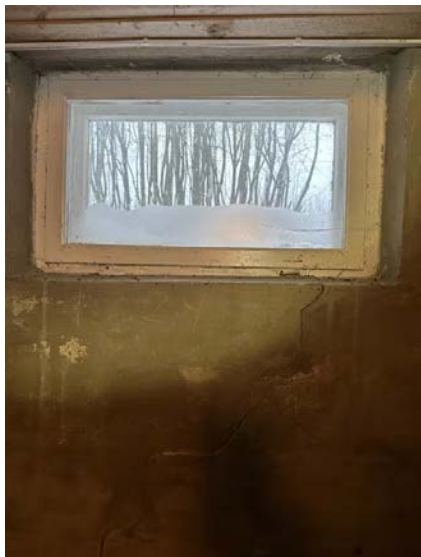
Viser skråriss som er symptom på setninger.
