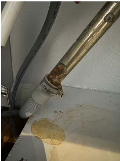
Viser irr og rust på vannrør til vaskemaskin.
