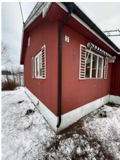
Taknedløp bør etableres med drensrør slik at takvannet kontrollert blir ført bort fra bygningen.
