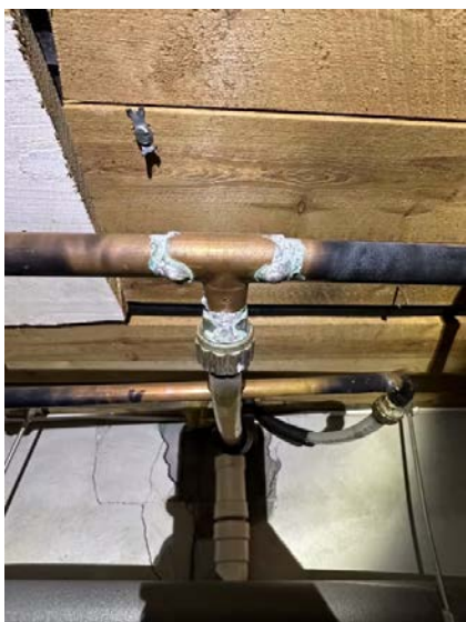
Det registreres irr på flere rør. Sot er registrert på rør og kan settes i sammenheng med tining av rør. Anbefaler ytterligere undersøkelser om frostproblematikk.
