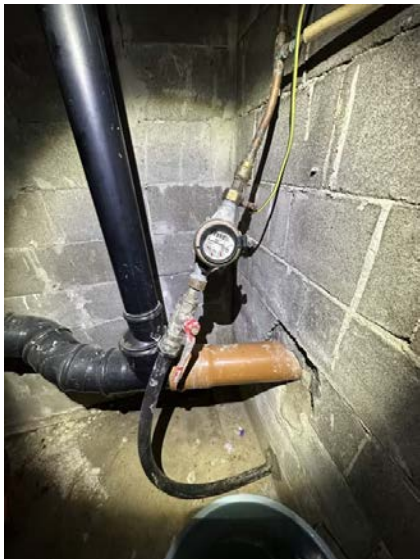
Viser vanninntak, stoppekran og vannmåler plassert i kjellerrom.
