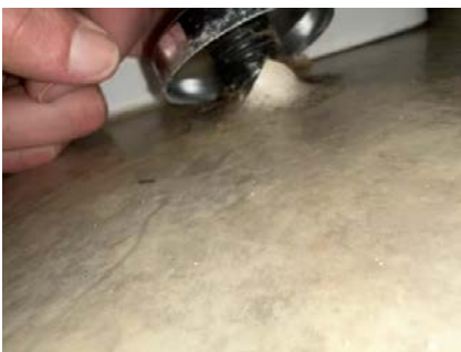
Løsningen/utførelsen rundt rørgjennomføringer i gulv gir fare for fukt inn i konstruksjoner.
