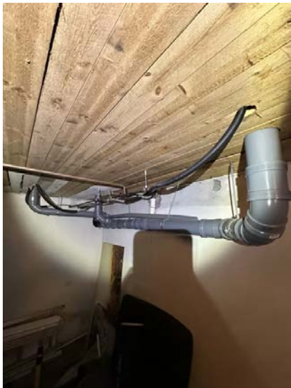
Viser avløpsinstallasjoner i kjeller.
