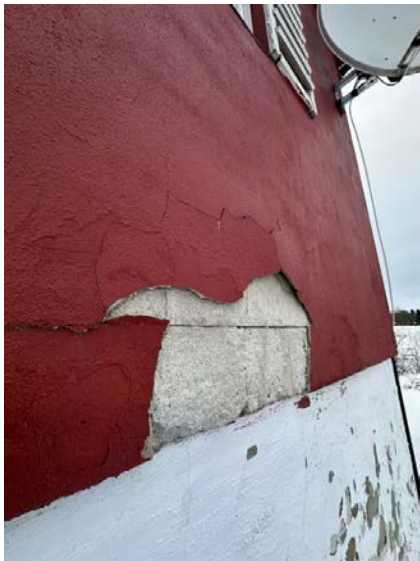
Viser løst murpuss.
