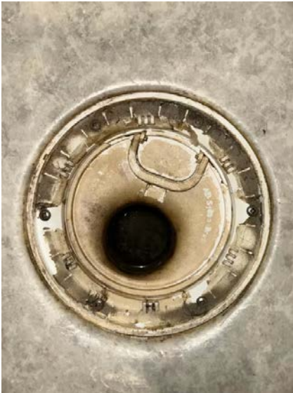
Det registreres klemring, men det er ikke registrert synlig gulvbelegg under klemring i sluk.
