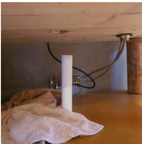
Avløpsrør vask på bad.
