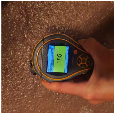
Fukt utslag på gulv.
