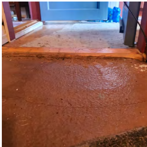
Sprekkdannelse på badromsgulv
