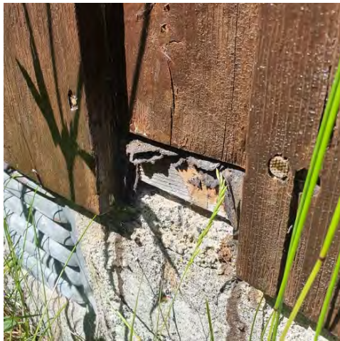
Mangelfull lufting av panel ved inngangsparti.
