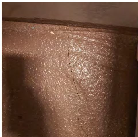
Sprekkdannelse på badromsgulv
