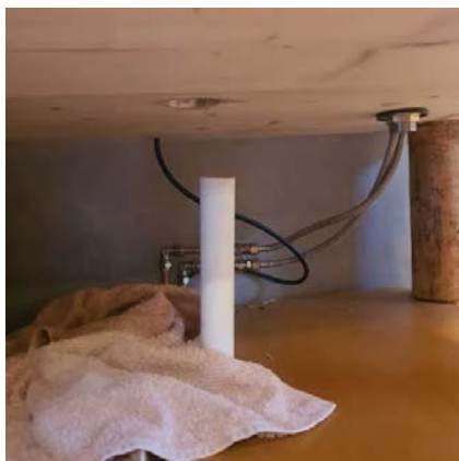
Avløpsrør vask på bad.
