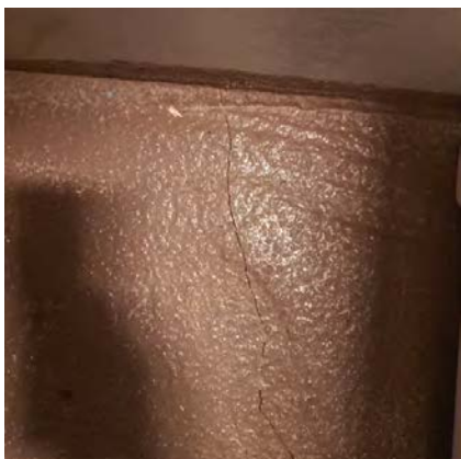
Sprekkdannelse på badromsgulv
