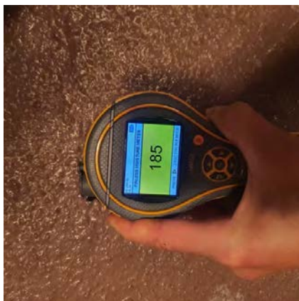
Fukt utslag på gulv.
