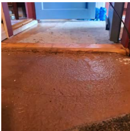
Sprekkdannelse på badromsgulv
