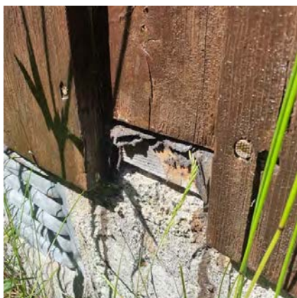
Mangelfull lufting av panel ved inngangsparti.
