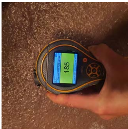
Fukt utslag på gulv.
