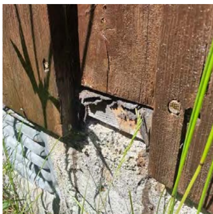
Mangelfull lufting av panel ved inngangsparti.
