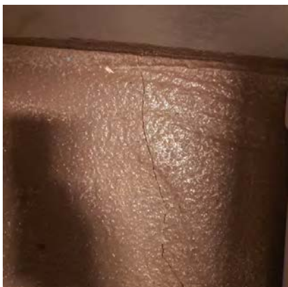
Sprekkdannelse på badromsgulv
