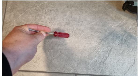
Det ble registrert bom i flis under trapp.
