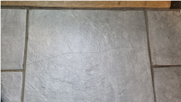
Sprekk i flis ved inngangsdør.
