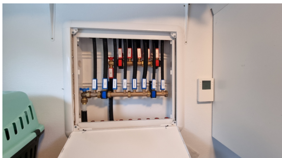
Kontroll av fordelerskap
