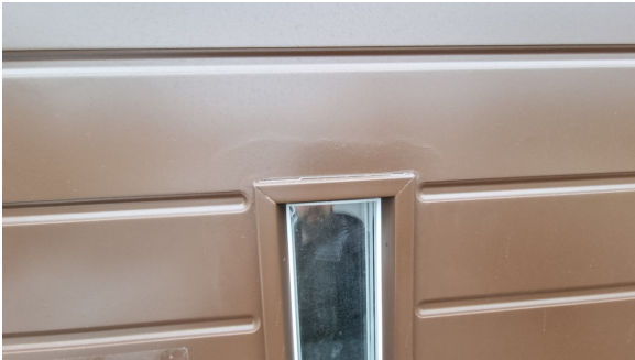
Fuktsvell i dørblad.
