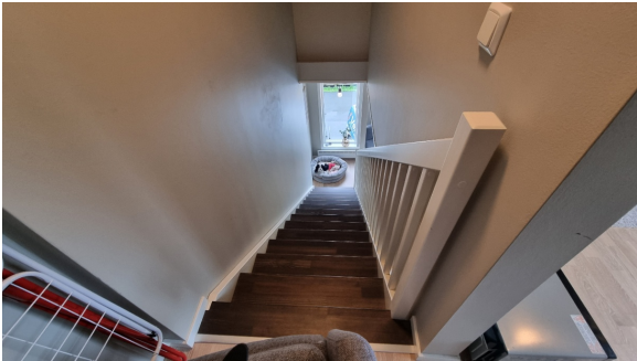
Det mangler håndløper på vegg i trappeløpet.
