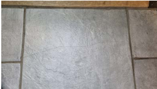
Sprekk i flis ved inngangsdør.
