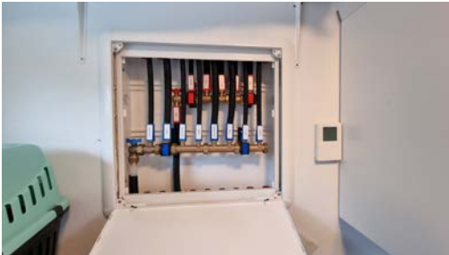
Kontroll av fordelerskap
