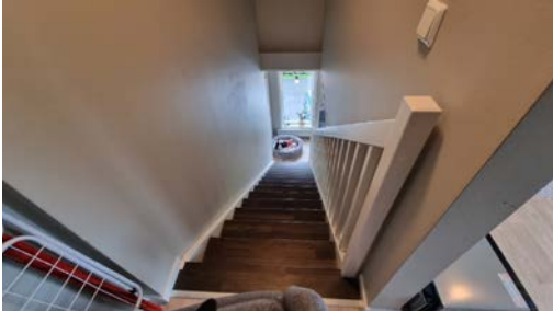
Det mangler håndløper på vegg i trappeløpet.
