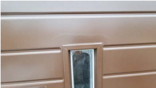
Fuktsvell i dørblad.
