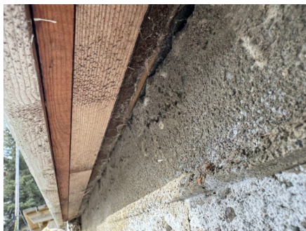
Kledningen er ikke ventilert hvor det er liggende kledning.
