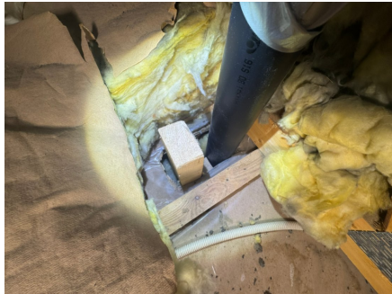
Eksempel på utettheter i dampsperran.
