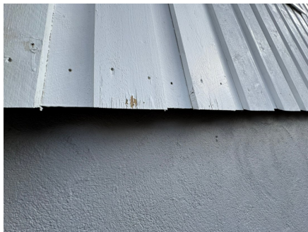
Eksempel på værslitt og sprekker i kledning.
