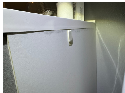
Fuktskader på innredningen.
