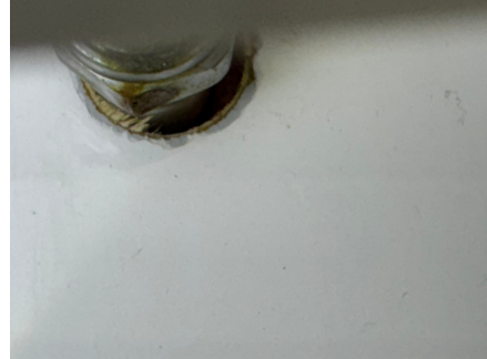
Utett gjennomgang under servanten.
