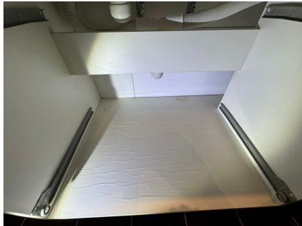
Skader på innredningen.
