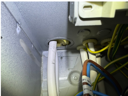
Åpning i sikringsskap.
