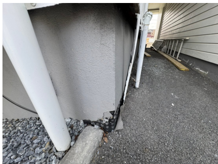
Eksempel på riss i grunnmuren.
