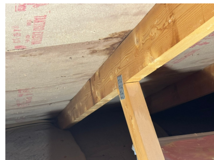
Eksempel på skader på taktroen som tyder på uett undertak.
