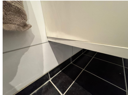
Skader på innredningen.
