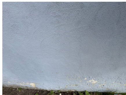
Eksempel på riss i grunnmuren.
