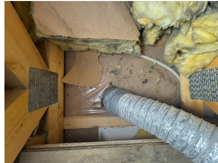
Eksempel på område som ikke er isolert.
