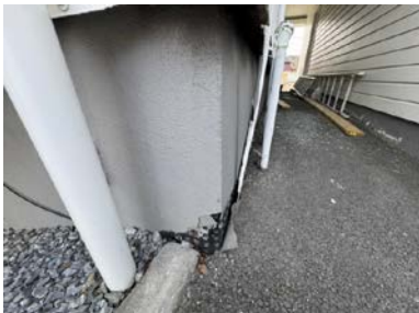
Eksempel på riss i grunnmuren.
