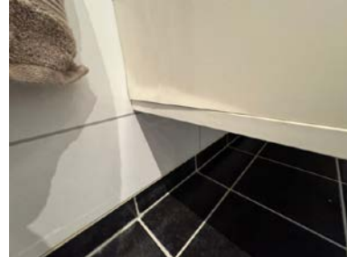
Skader på innredningen.
