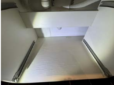
Skader på innredningen.
