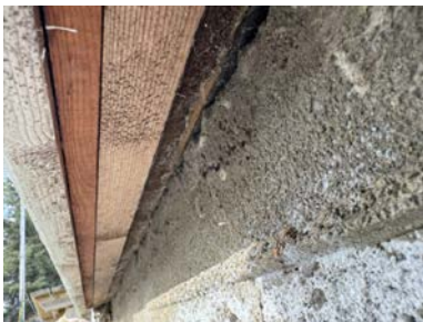
Kledningen er ikke ventilert hvor det er liggende kledning.
