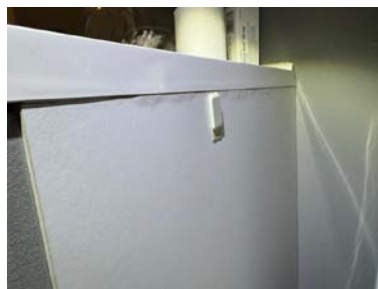
Fuktskader på innredningen.
