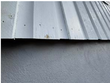
Eksempel på værslitt og sprekker i kledning.
