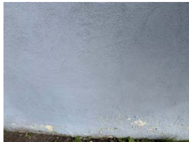
Eksempel på riss i grunnmuren.
