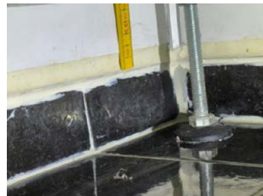
Fugemassen mellom baderomsplaten og bunnlisen.
