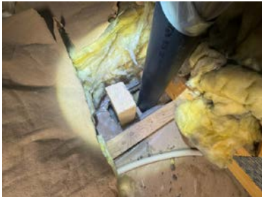
Eksempel på utettheter i dampsperran.
