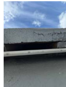
Det er ikke montert musesperre hvor det er stående kledning.
