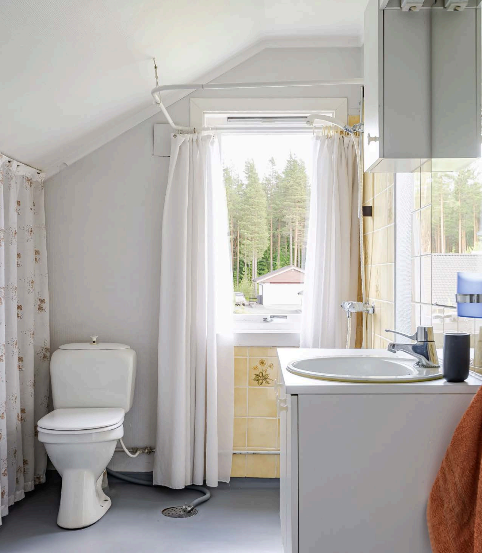
Baderom i 2. etasje fra 1960-tallet. Baderommet har fått TG3 i tilstandsrapporten og må oppgraderes for å tåle normal bruk etter dagens krav.
