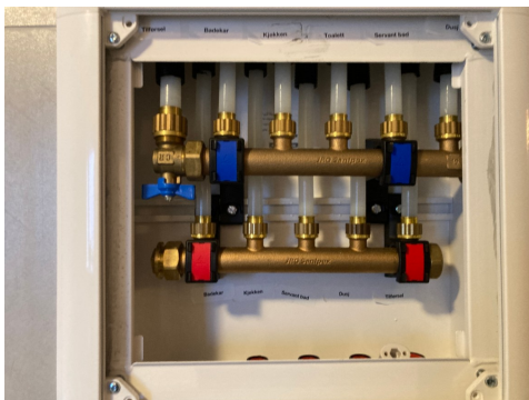
Fordelerskap for rør i rør (bad)
