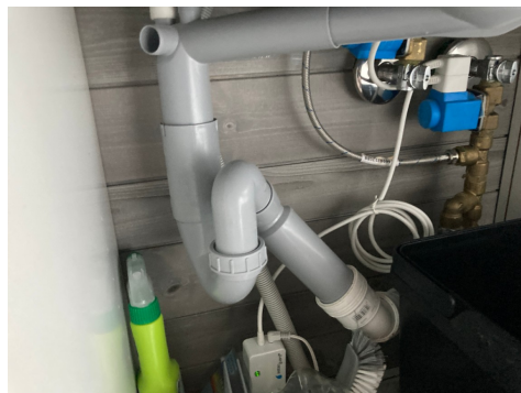
Rørøpplagg i skap under vask
