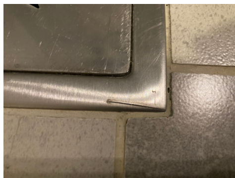
Sprekk i ramme til sluk i dusj
