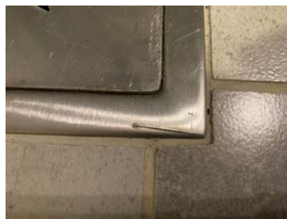
Sprekk i ramme til sluk i dusj
