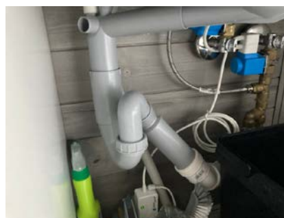
Røropplegg i skap under vask
