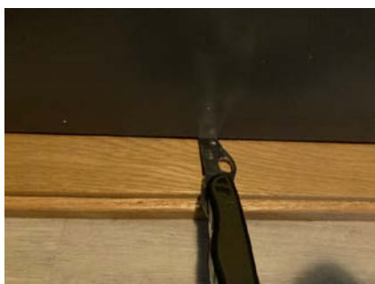
Smal luftesplate under dør
