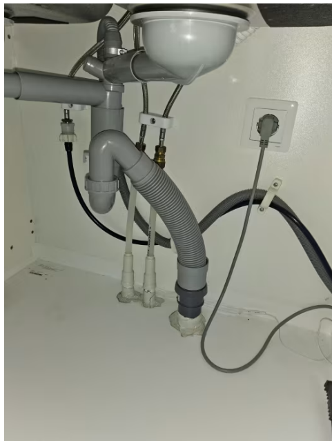
Bilde viser røropplegg under oppvaskkum på kjøkken.
