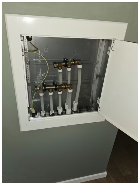
Bilde viser fordelerskap for rør i rørsystem i entré.
