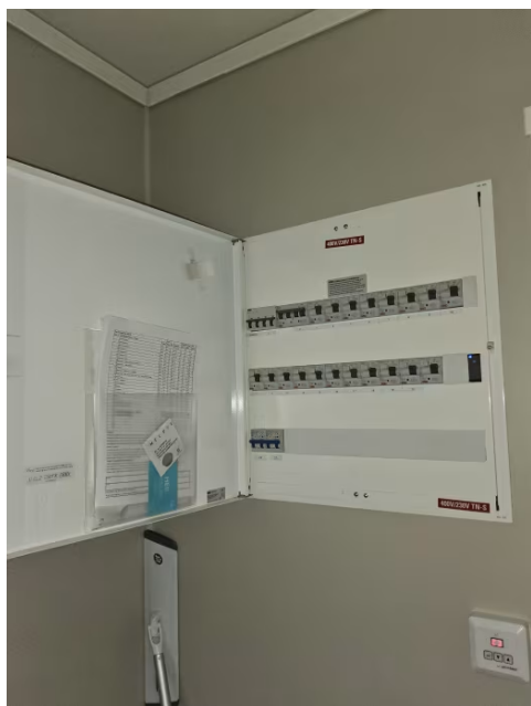
Bilde viser sikringsskap.
