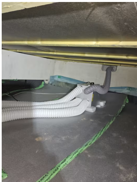
Bilde viser krypkjeller med krypgrunnsavfukter.
