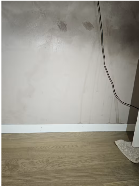
Bilde viser fuktmerker på vegg på soverom.
