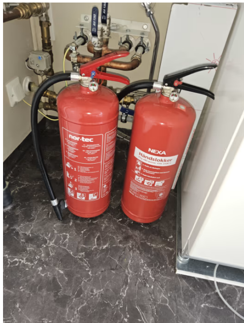
Bilde viser brannslukningsapparat.
