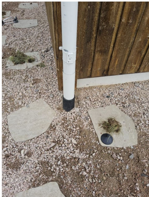
Bilde viser taknedløp ført ned i drensrør.
