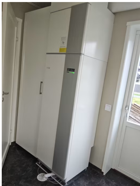
Bilde viser avtrekksvarmepumpe.
