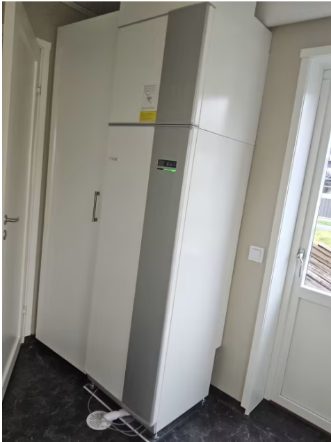
Bilde viser avtrekksvarmepumpe.
