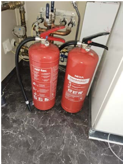
Bilde viser brannslukningsapparat.
