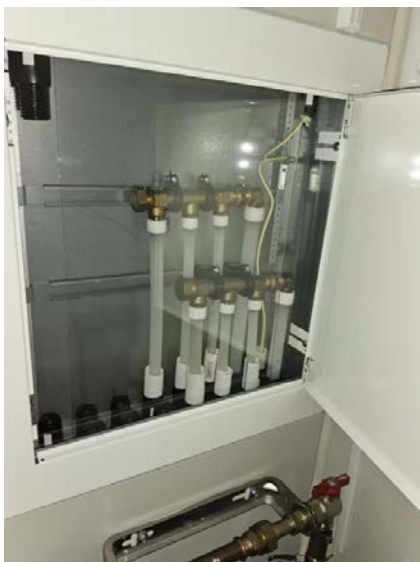
Bilde viser fordelerskap for rør i rørsystem på vaskerom.
