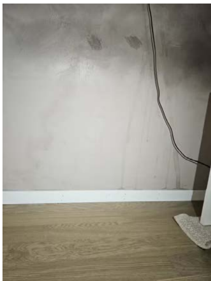
Bilde viser fuktmerker på vegg på soverom.
