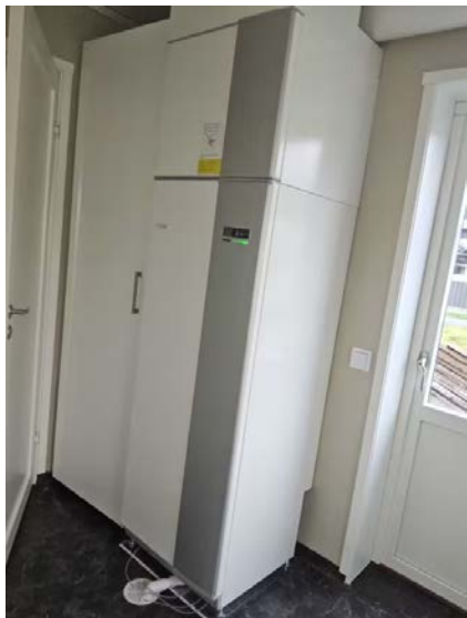
Bilde viser avtrekksvarmepumpe.
