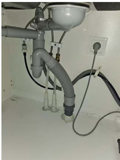
Bilde viser røropplegg under oppvaskkum på kjøkken.
