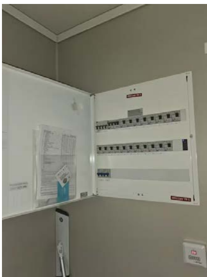
Bilde viser sikringsskap.
