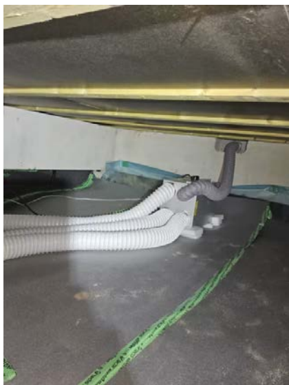
Bilde viser kryp kjeller med krypgrunnsavfukter.
