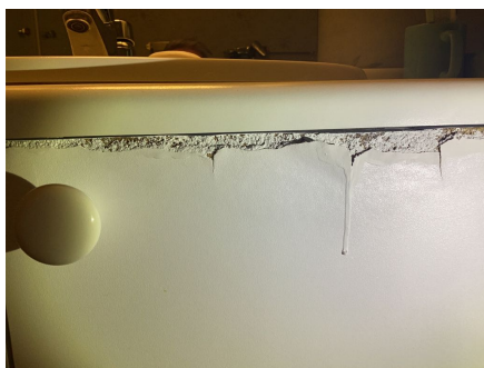
Kraftig slitasje på fronter på servantinnredning.
