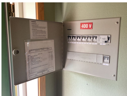
Sikringsskap i gang.
