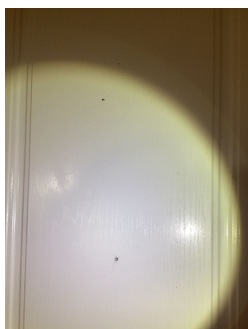
Noen små skruehull i to fronter.
