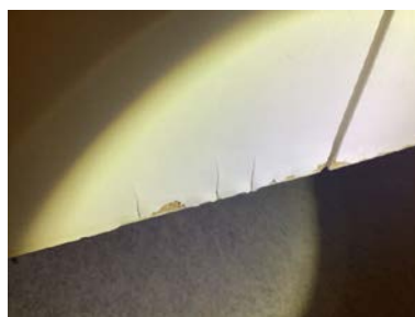
Kraftig slitasje på fronter på servantinnredning.
