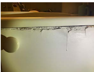
Kraftig slitasje på fronter på servantinnredning.
