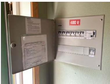
Sikringsskap i gang.
