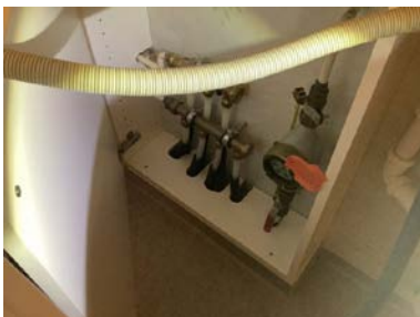
Vanninntak med måler og stoppekran på bad.
