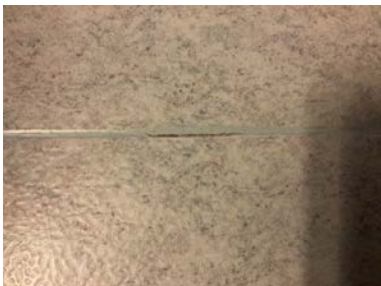
Sveiseskjøt på gulv begynner å sprekke opp.
