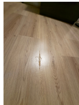
Skade i laminat på hovedsoverom
