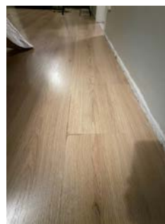
Skade i laminat på hovedsoverom
