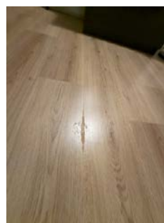
Skade i laminat på hovedsoverom
