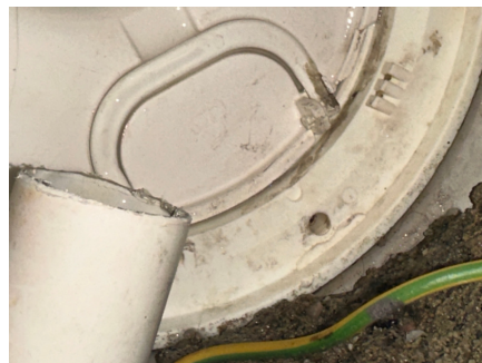
Manglende skrue i sluk
