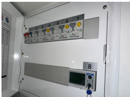
Sikringsskap med automatsikringer.
