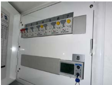
Sikringsskap med automatsikringer.
