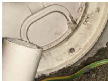
Manglende skrue i sluk
