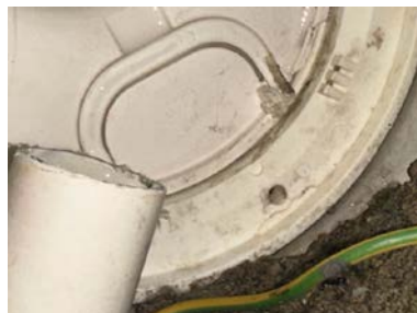
Manglende skrue i sluk
