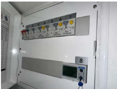
Sikringsskap med automatsikringer.
