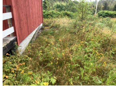
Utilfredsstillende fall fra bygning.
