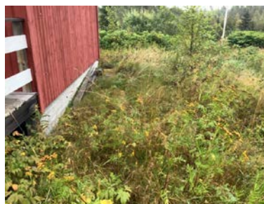
Utilfredsstillende fall fra bygning.
