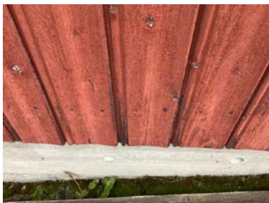
Værslitt kledning som har kuvet seg.
