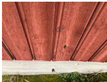
Værslitt kledning som har kuvet seg.
