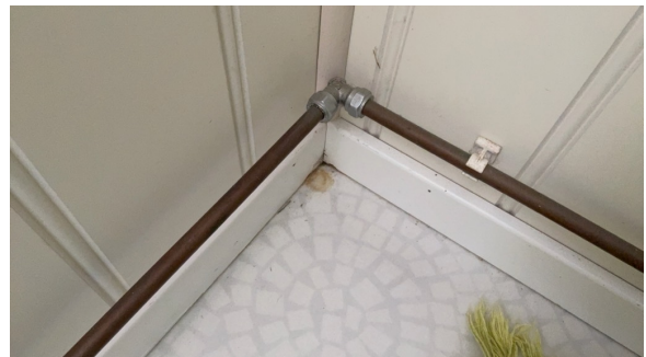
Misfarging på gulv under kobling. Kan ha vært utetthet, men dette er ukjent.
