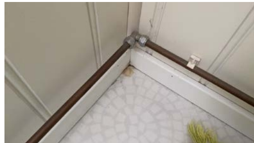
Misfarging på gulv under kobling. Kan ha vært utetthet, men dette er ukjent.
