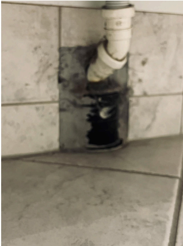
Rørgjennomføring i overgang gulv/vegg. Ufagmessig løsning.
