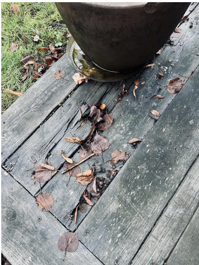
Skade på markterrasse.
