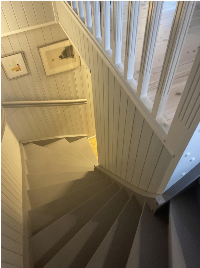
Manglende håndløper på vegg.
