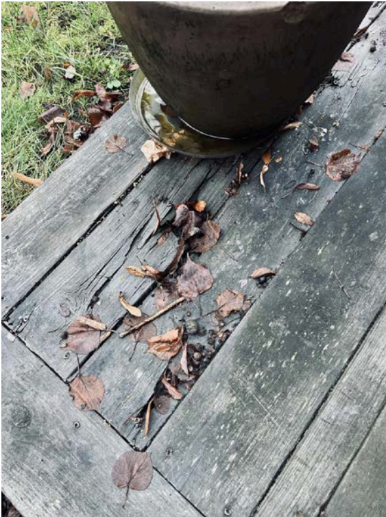
Skade på markterrasse.
