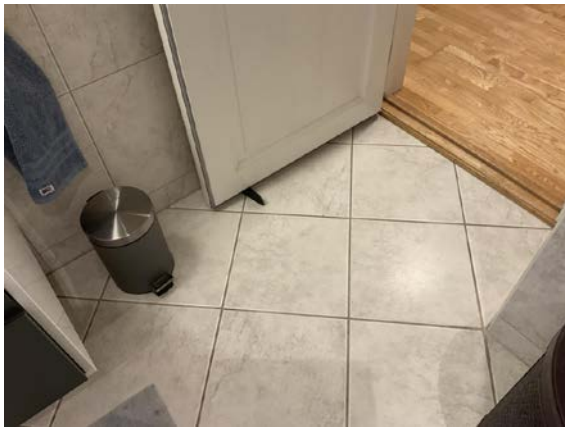
Flatt gulv uten fall mot sluk, mellom servantskap og dør.
