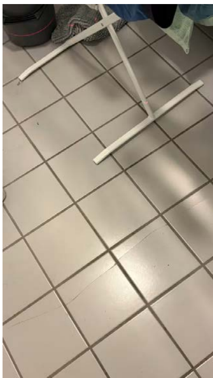
Bildet viser sprekke i flis gulv på badet.
