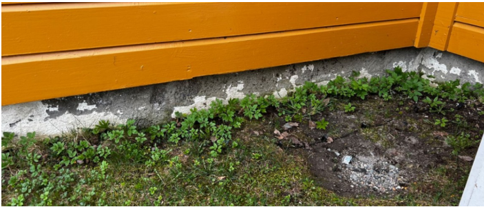
Mur med skader
