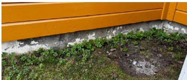
Mur med skader
